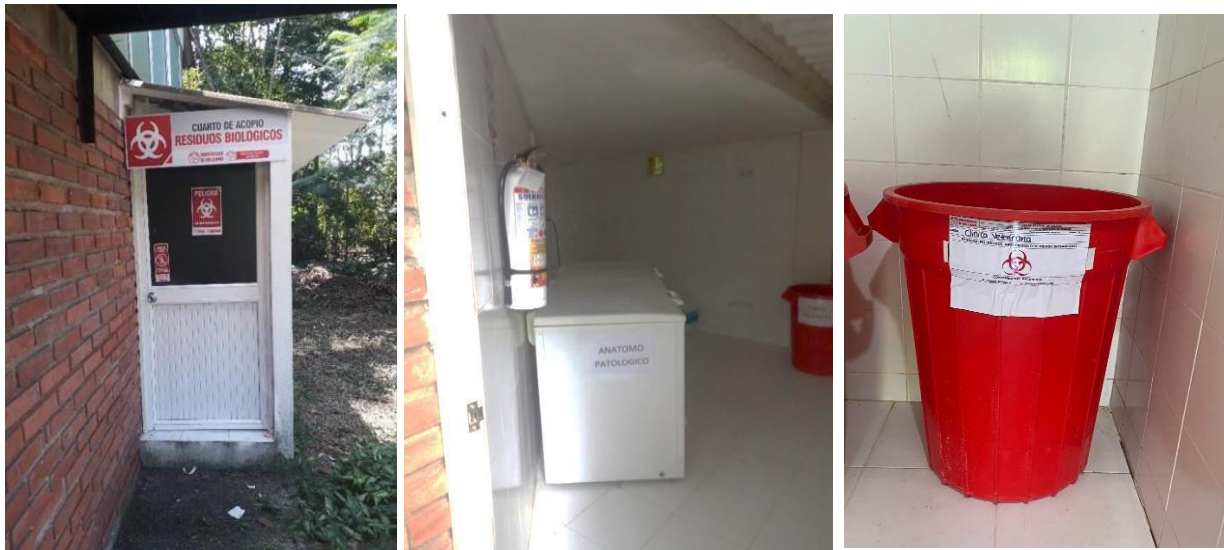
Figura 24. Cuarto acopio de almacenamiento temporal de residuos infecciosos de clínica veterinaria.
